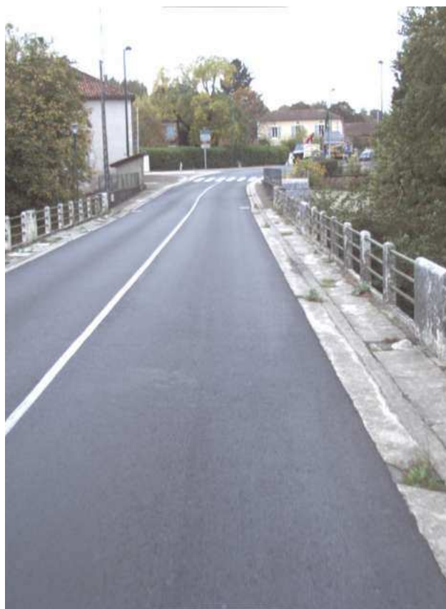
État actuel du pont sur la Baise à St Jean-Poutge
